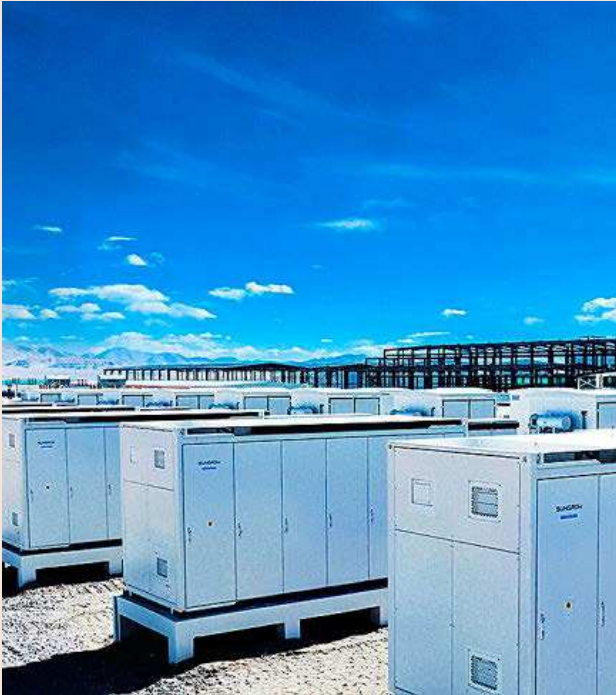
Las baterías conectadas a la red (BESS) son la revolución eléctrica.
