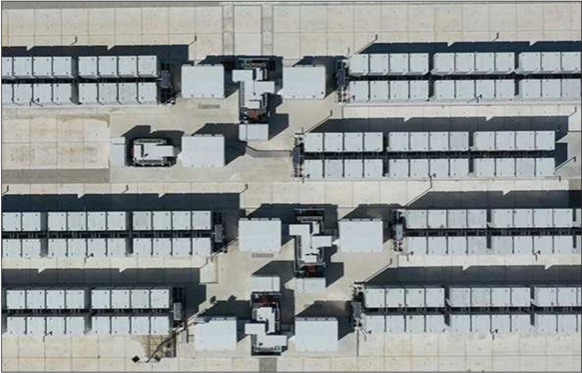
Vista aérea de una planta de baterías de Return. EE
