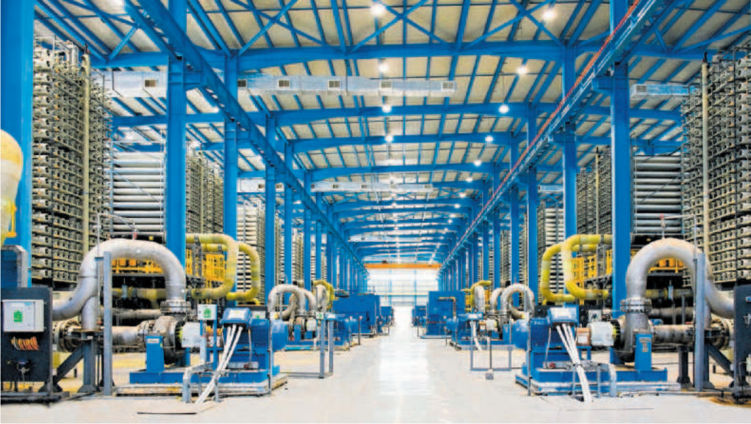
Planta desalinizadora de ósmosis inversa (OI) en Al Taweelah Abu Dabi, en una imagen proporcionada por la compañía.
