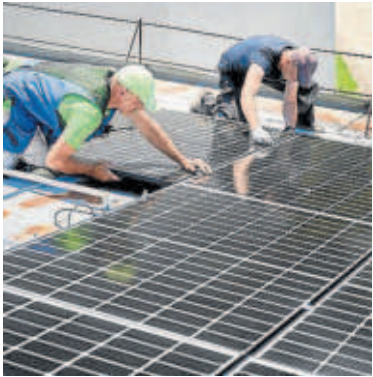
Módulos fotovoltaicos. Foto: S.U.
