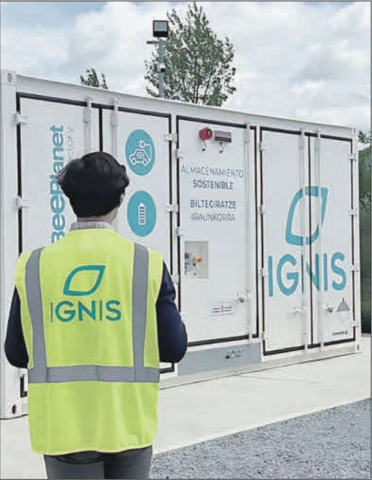
Instalaciones de Ignis. EE
