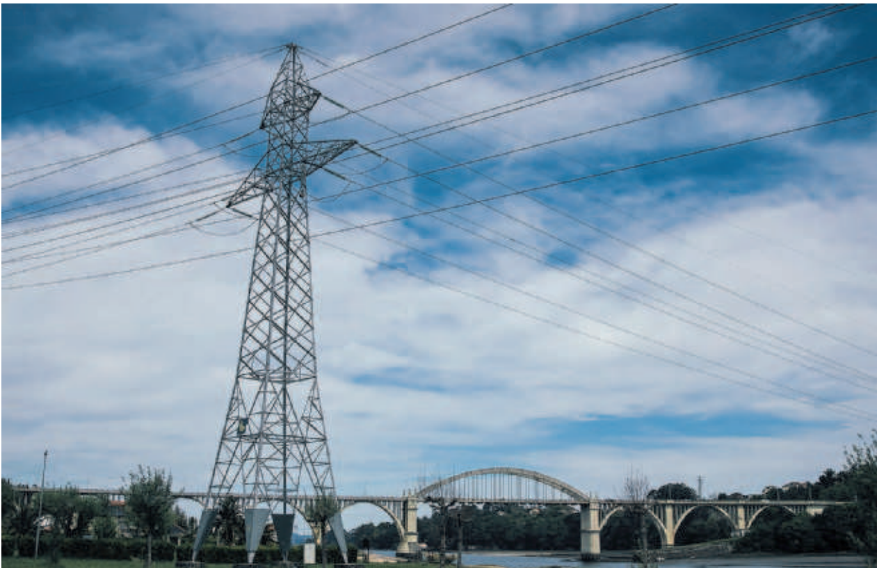
Torreta de alta tensión en la subestación de O Pedrido (A Coruña). ÓSCAR CORRAL
