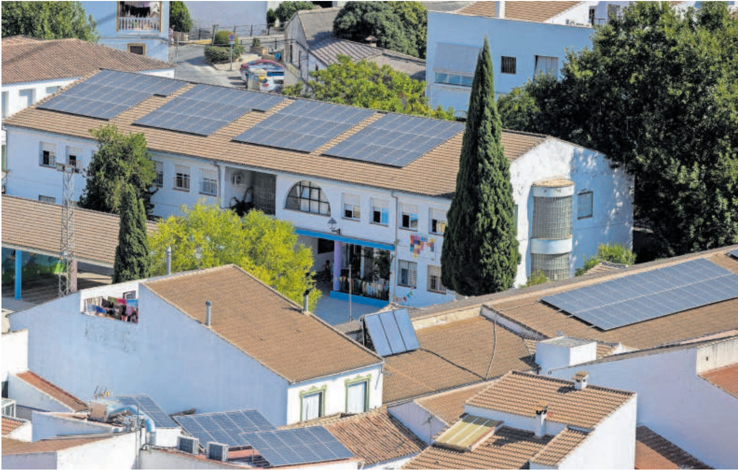
Placas solares instaladas en viviendas de Alcalá del Valle (Cádiz), el 18 de septiembre. ÁLVARO CABRERA
