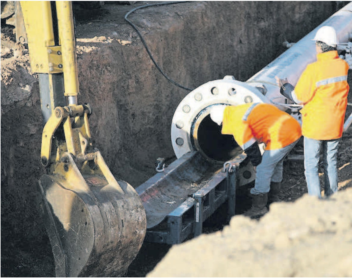
Las instalaciones del gasoducto Medgaz, en Almería
