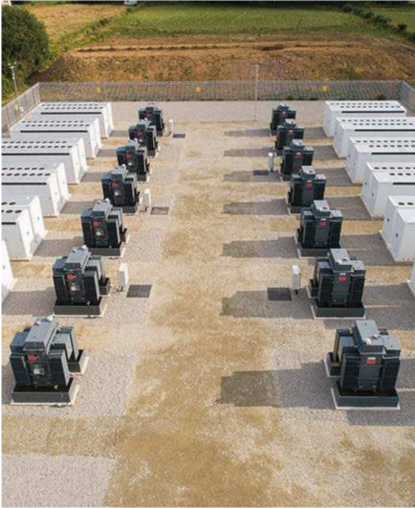
Almacenamiento con baterías. FRV
