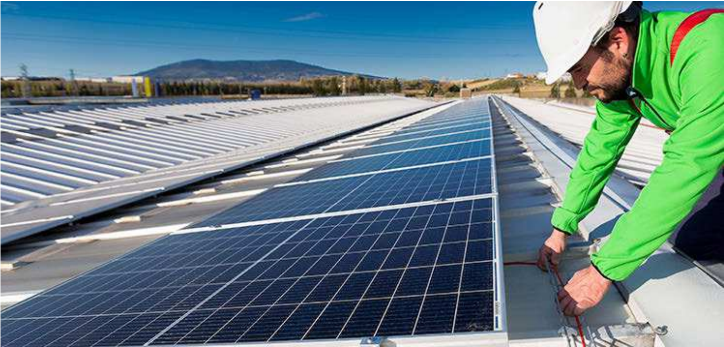
Instalación de autoconsumo realizada por Fené Energía. J. Zalba
