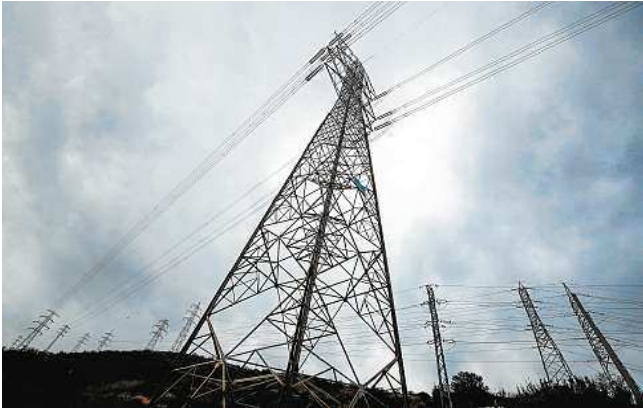
Uno de los tendidos eléctricos que atraviesan la Comunidad de Madrid. Reuters
