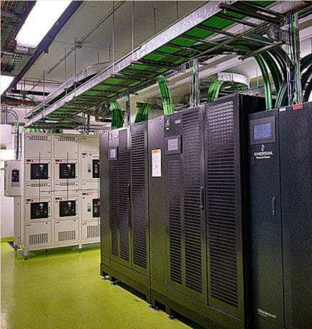
Imagen del interior de un centro de datos.
