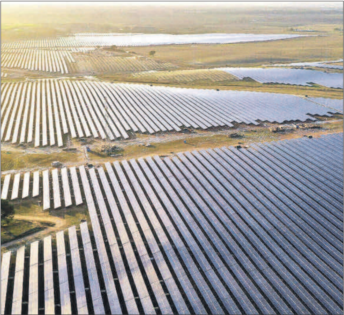
Una planta fotovoltaica EE
