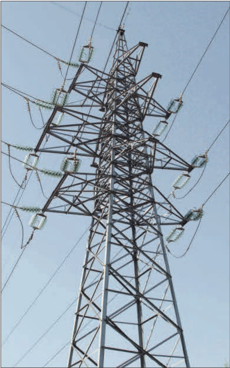
Foto de un tendido eléctrico. EE
