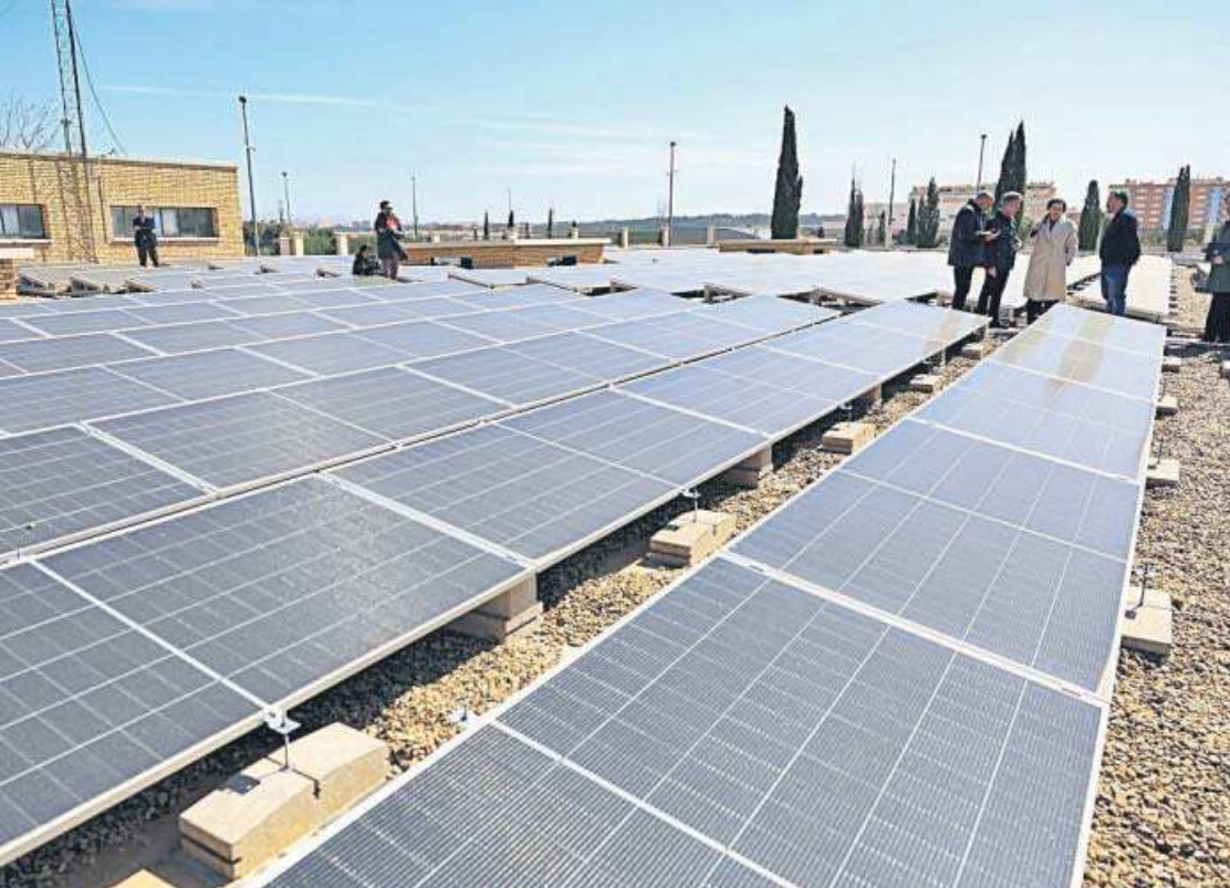
Placas fotovoltaicas destinadas al autoconsumo.
