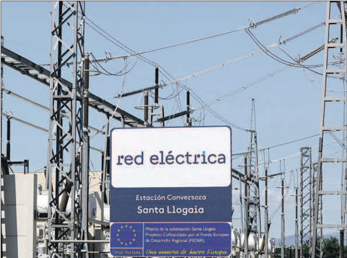
Un tendido eléctrico de la interconexión con Francia. REUTERS
