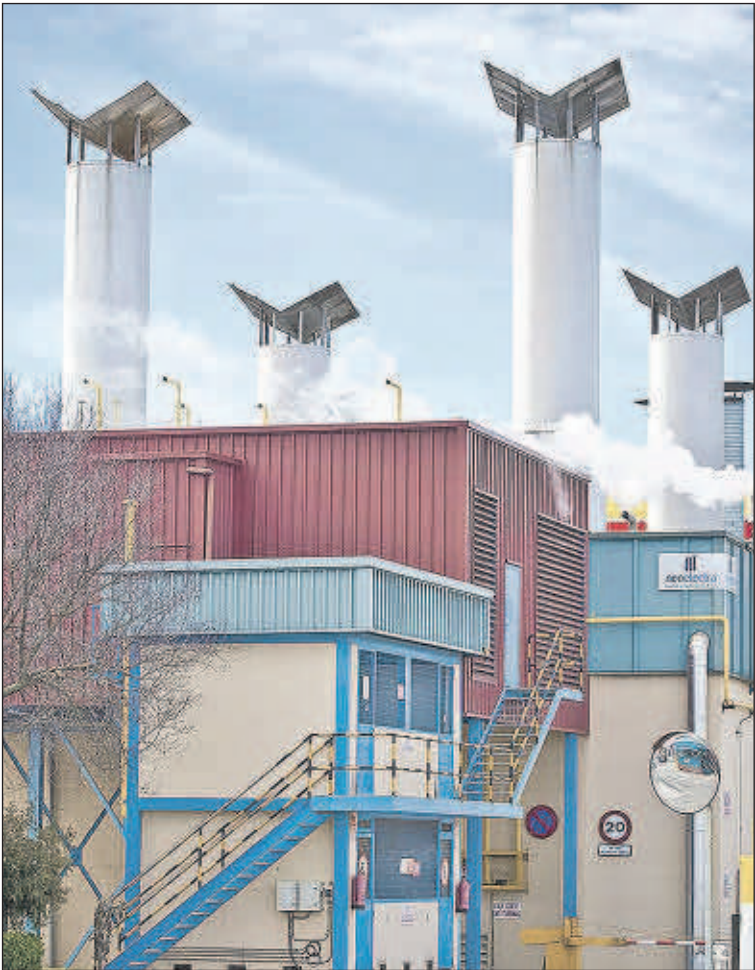
Instalación de Neoelectra. EE
