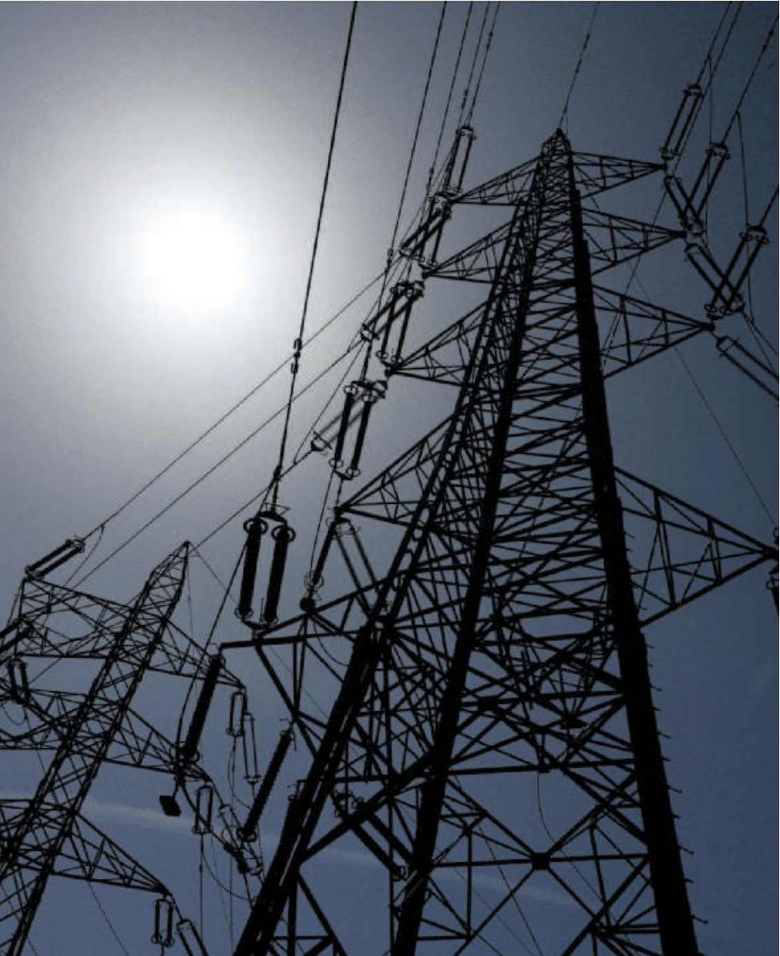
Torretas de la subestación eléctrica Los Ramos, en Málaga. JORGE ZAPATA (EFE)
