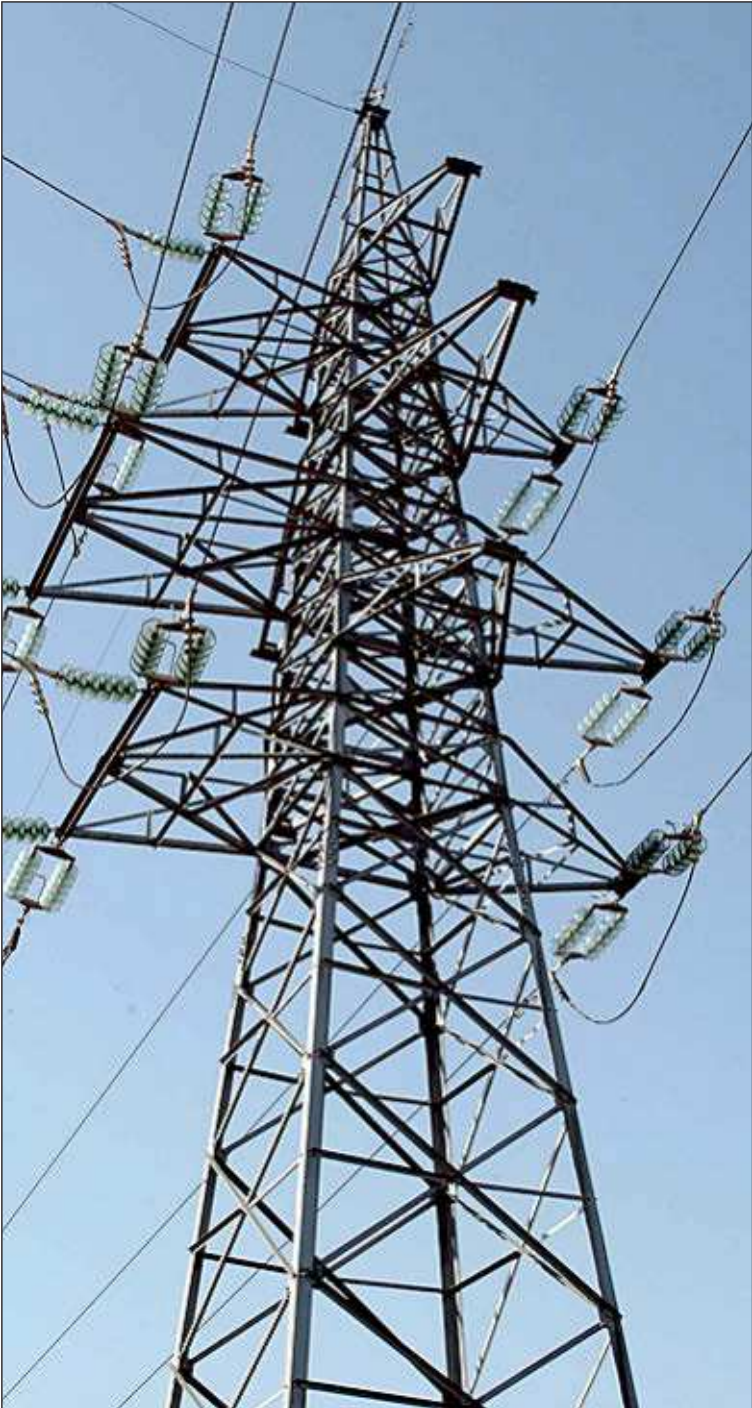
Un tendido eléctrico. EE
