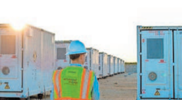
Instalación de baterías de Recurrent Energy. CEDIDA
