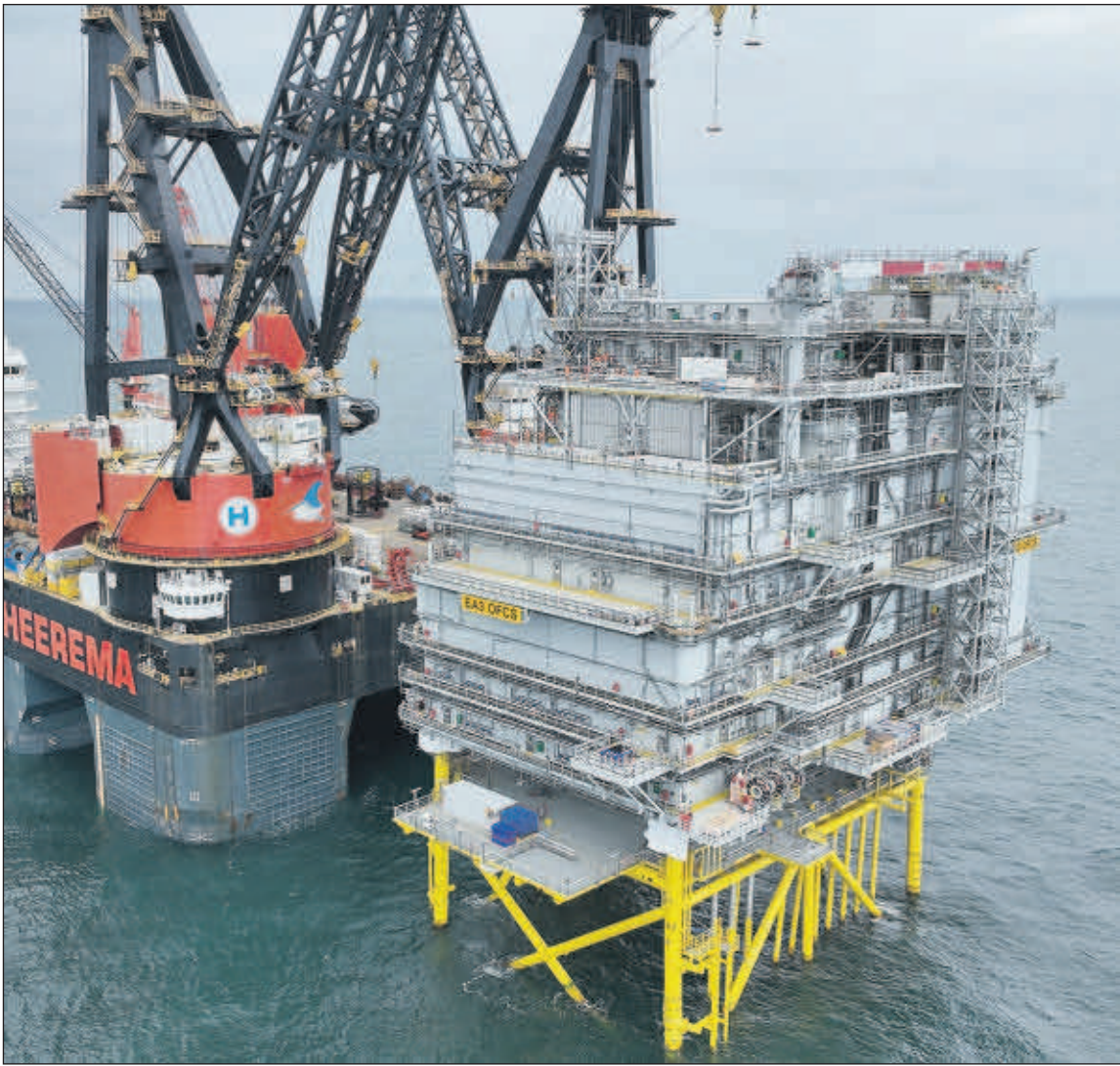
Una subestación de un parque eólico marino. EE
