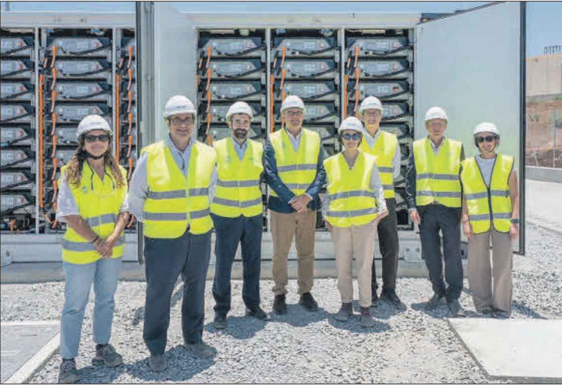
GROIZARD VISITA PROYECTOS DE ALMACENAMIENTO DE NATURGY. El secretario de Estado de Energía, Joan Groizard, y el delegado de Gobierno en la Comunidad Autónoma de Canarias, Anselmo Pestana, visitaron dos de los cuatro proyectos de hibridación fotovoltaica con baterías que Naturgy promueve en Canarias y que estarán concluidos durante 2026. Los cuatro proyectos suponen una inversión conjunta de casi 20 millones. EE
