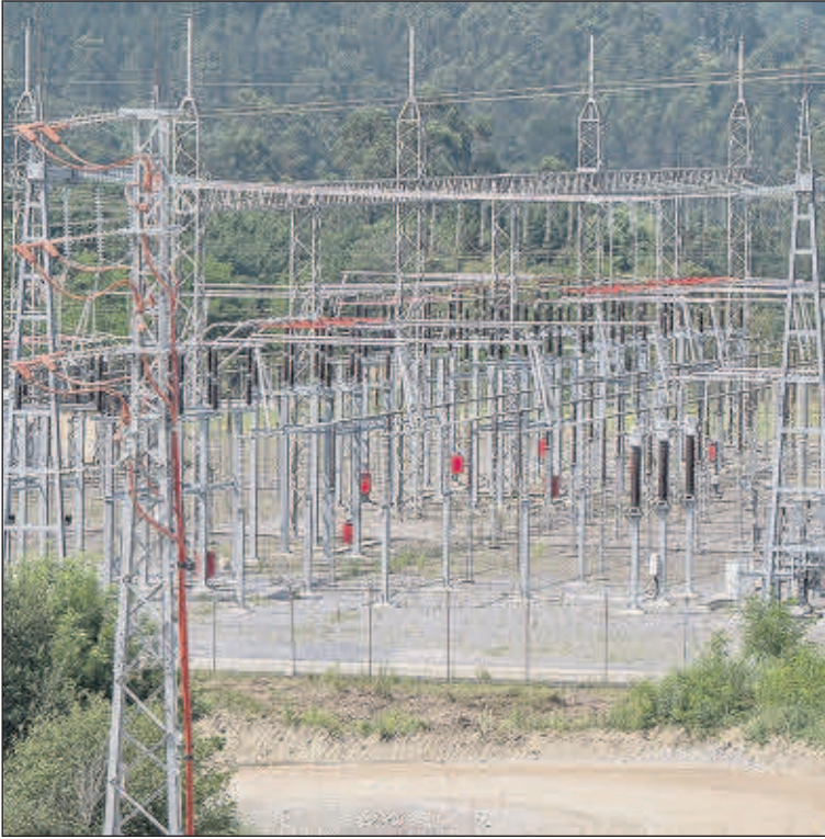
Subestación eléctrica. EUROPA PRESS
