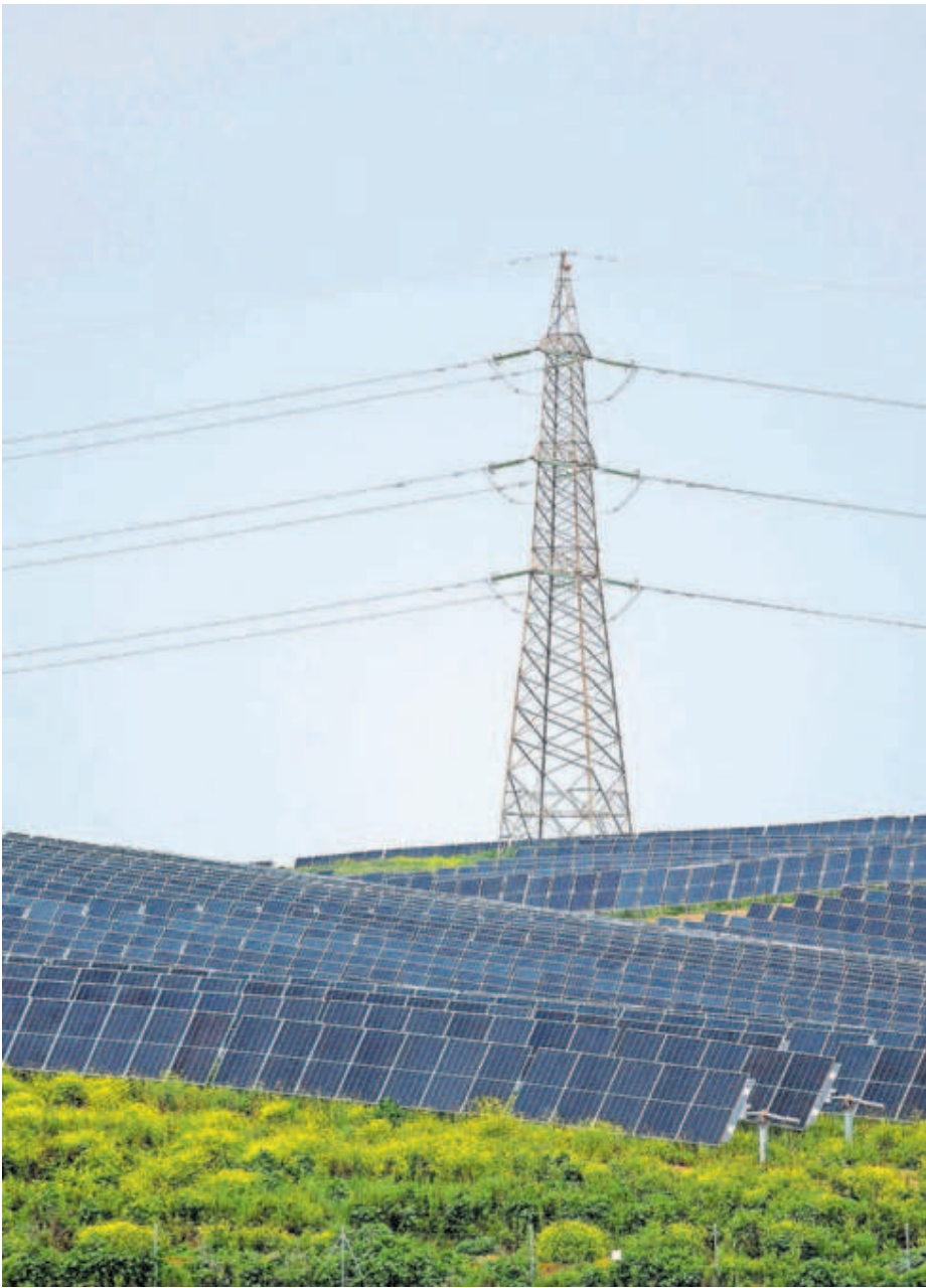
Planta fotovoltaica en la localidad sevillana de Guillena. PACO PUENTES
