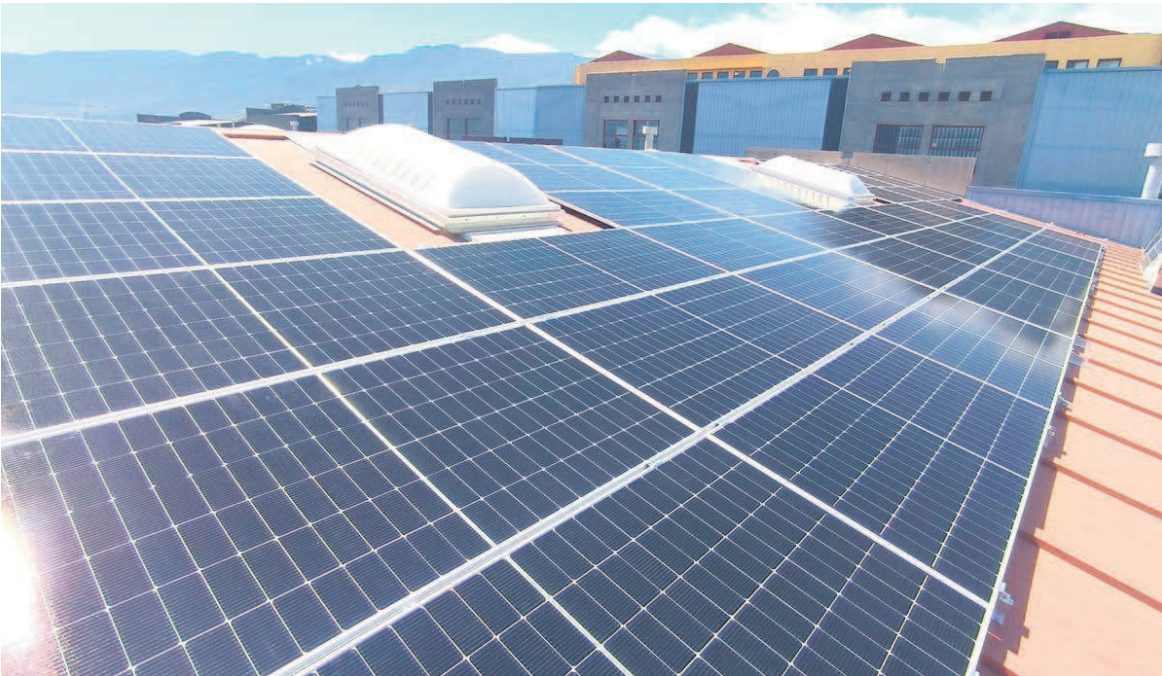
PLACAS FOTOVOLTAICAS EN CUBIERTAS DE NAVES DEL POLÍGONO INDUSTRIAL LA CAMPANA (EL ROSARIO). DA
