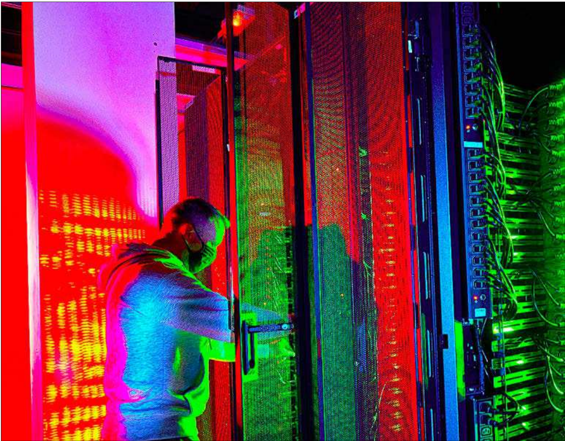
Un operario en el interior de un centro de datos de Madrid. CARLOS GARCÍA POZO
