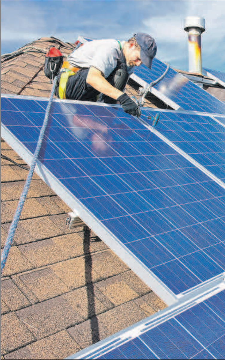
Una instalación de autoconsumo. EE
