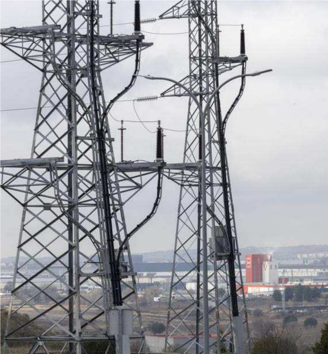
Entre 2020 y 2024 Castilla-La Mancha recibió 2.857 megavatios de nuevas conexiones de demanda eléctrica. / JAVIER POZO
