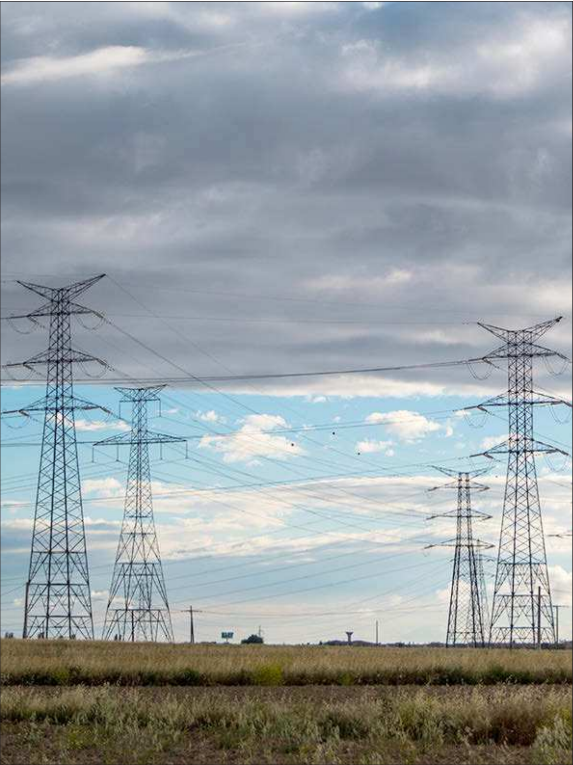
Un tendido eléctrico EE
