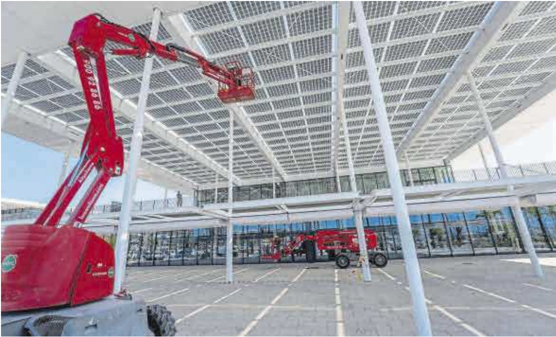
Una de las pérgolas con placas fotovoltaicas de la zona de restauración del Port Olímpic.
