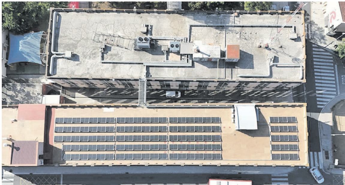
Imatge d'arxiu de la instal·lació fotovoltaica de l'edifici Bullidor / AJUNTAMENT DE RUBÍ
