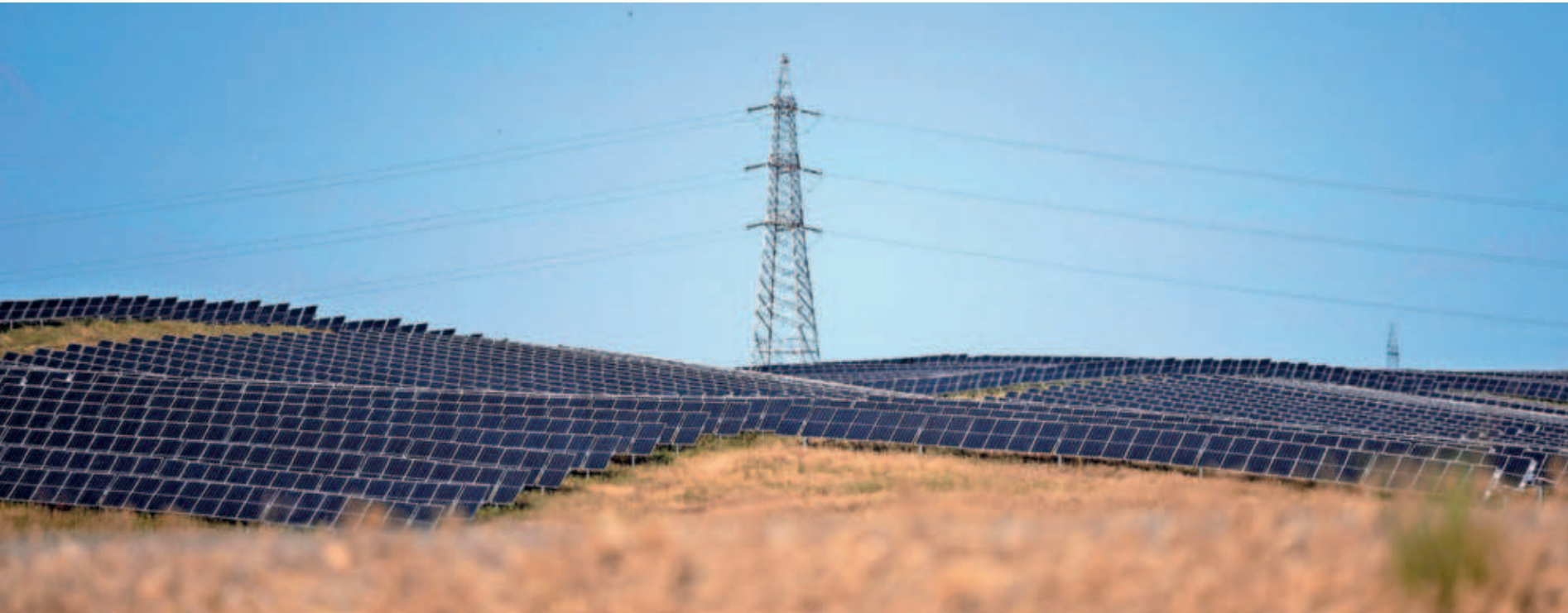
Placas solares en Guillena, Sevilla. PACO PUENTES
