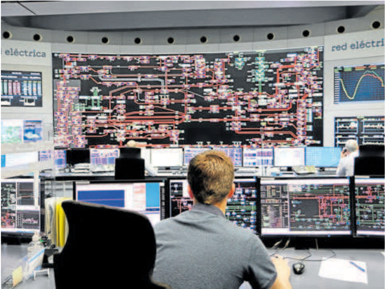
Centro de control y operaciones de Red Eléctrica. REE
