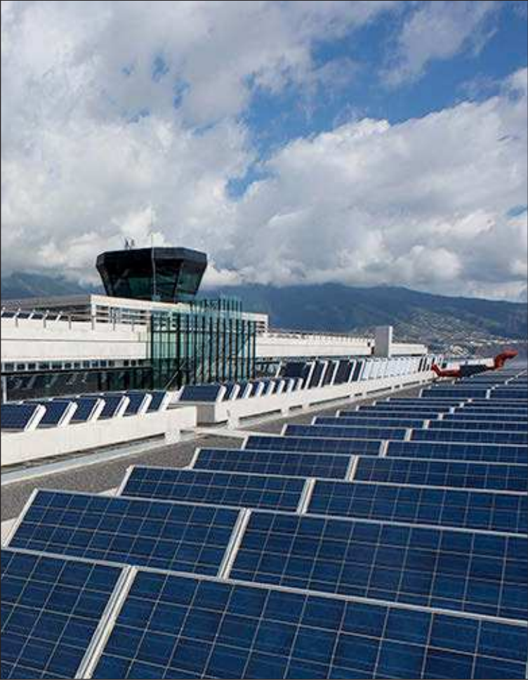
Una de las plantas fotovoltaicas de Aena en aeropuertos. AENA
