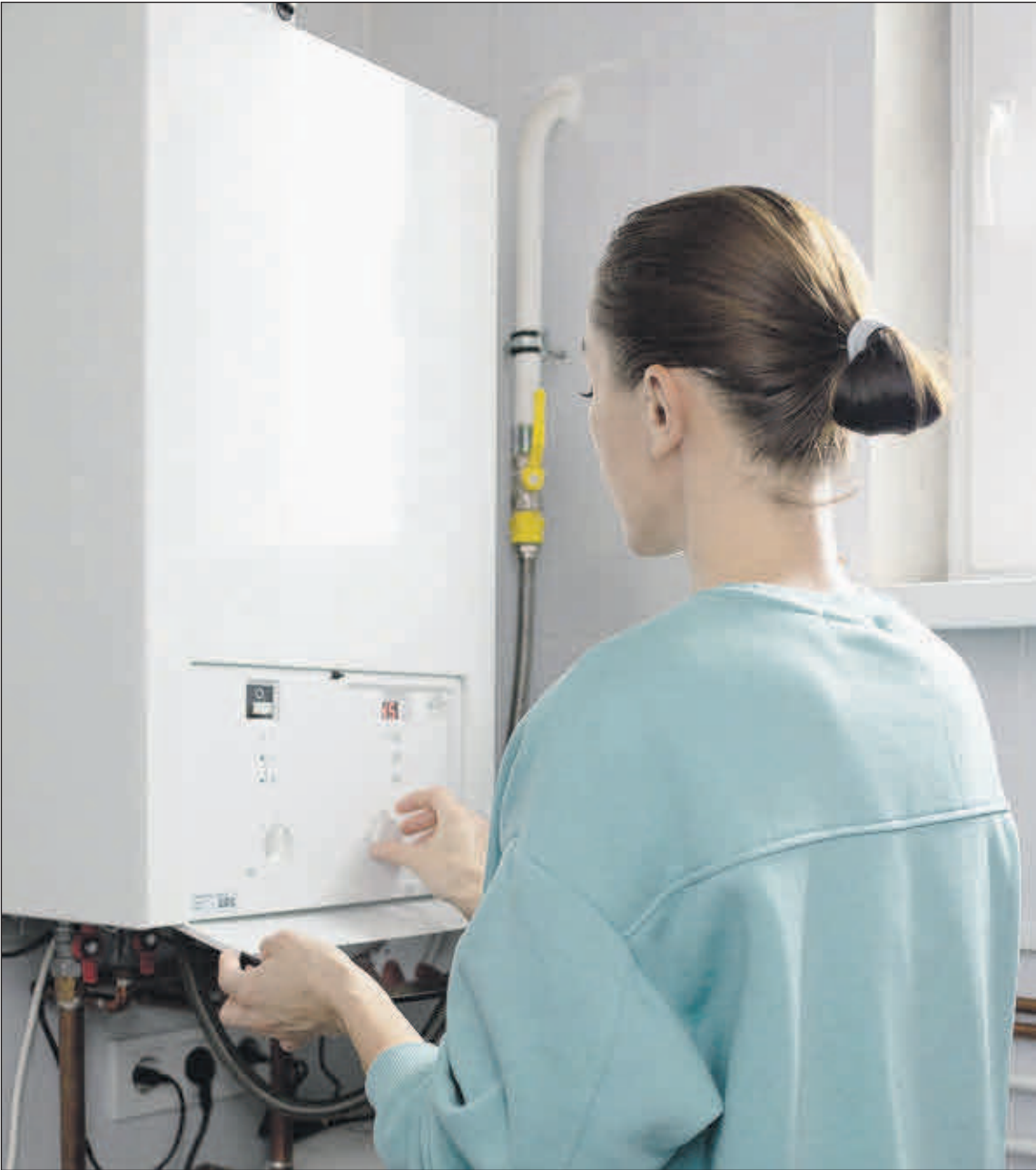
Un cliente doméstico con su caldera de gas. ISTOCK
