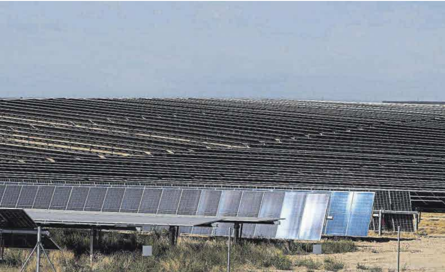
Un parc de plaques solars, el tipus d'instal·lació que produeix energia renovable a gran escala, a Alcarràs.
