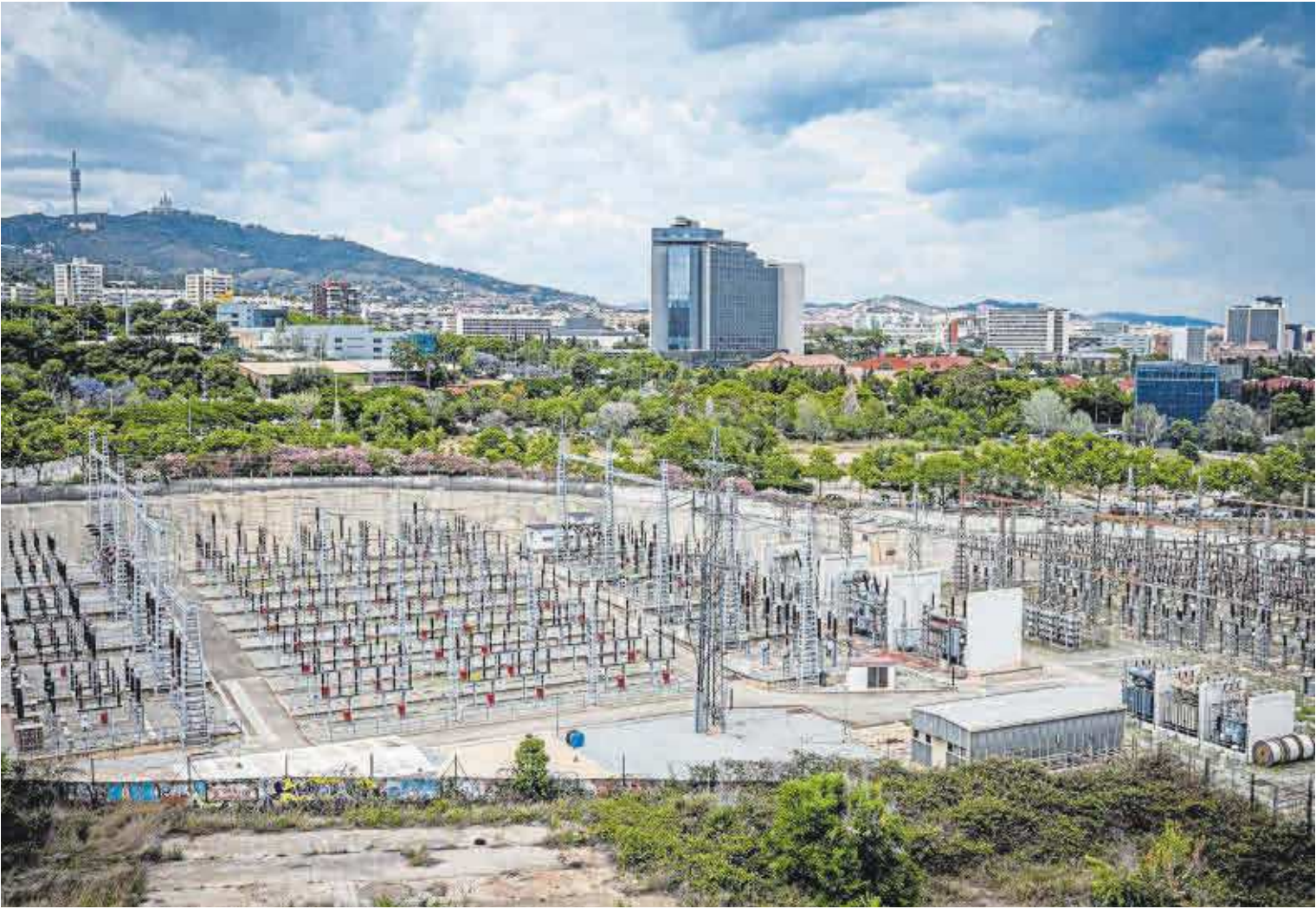
La subestación eléctrica de Collblanc, en L’Hospitalet de Llobregat.
