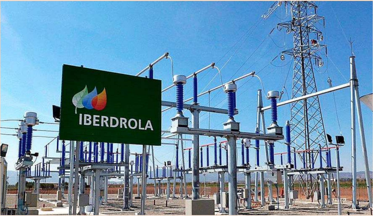
Subestación eléctrica de Iberdrola.
