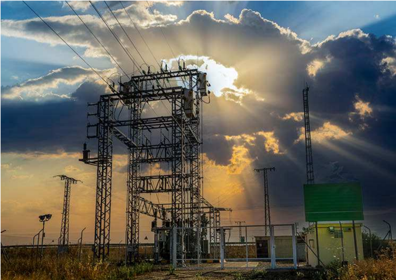
Subestación para la producción de electricidad.
