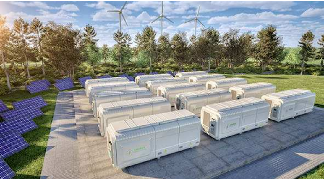
Paneles solares, contenedores de baterías y aerogeneradores.
