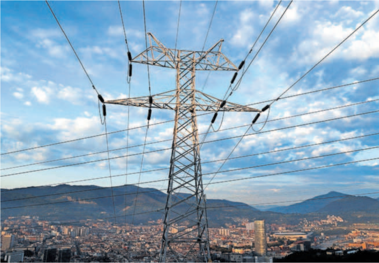
Una torre de transporte de alta tensión de REE, con la ciudad de Bilbao al fondo. EFE
