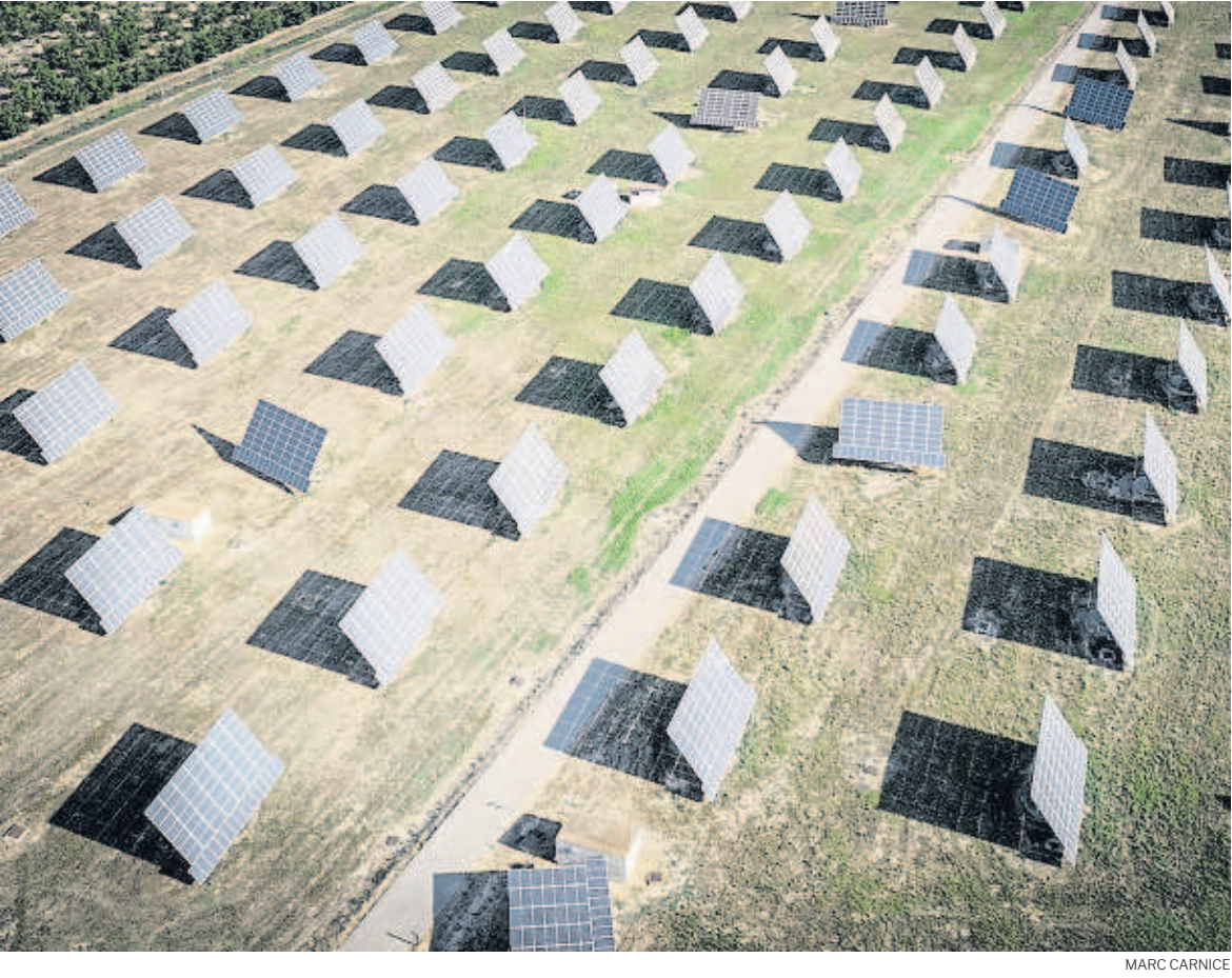
Una instalación fotovoltaica en Lleida
