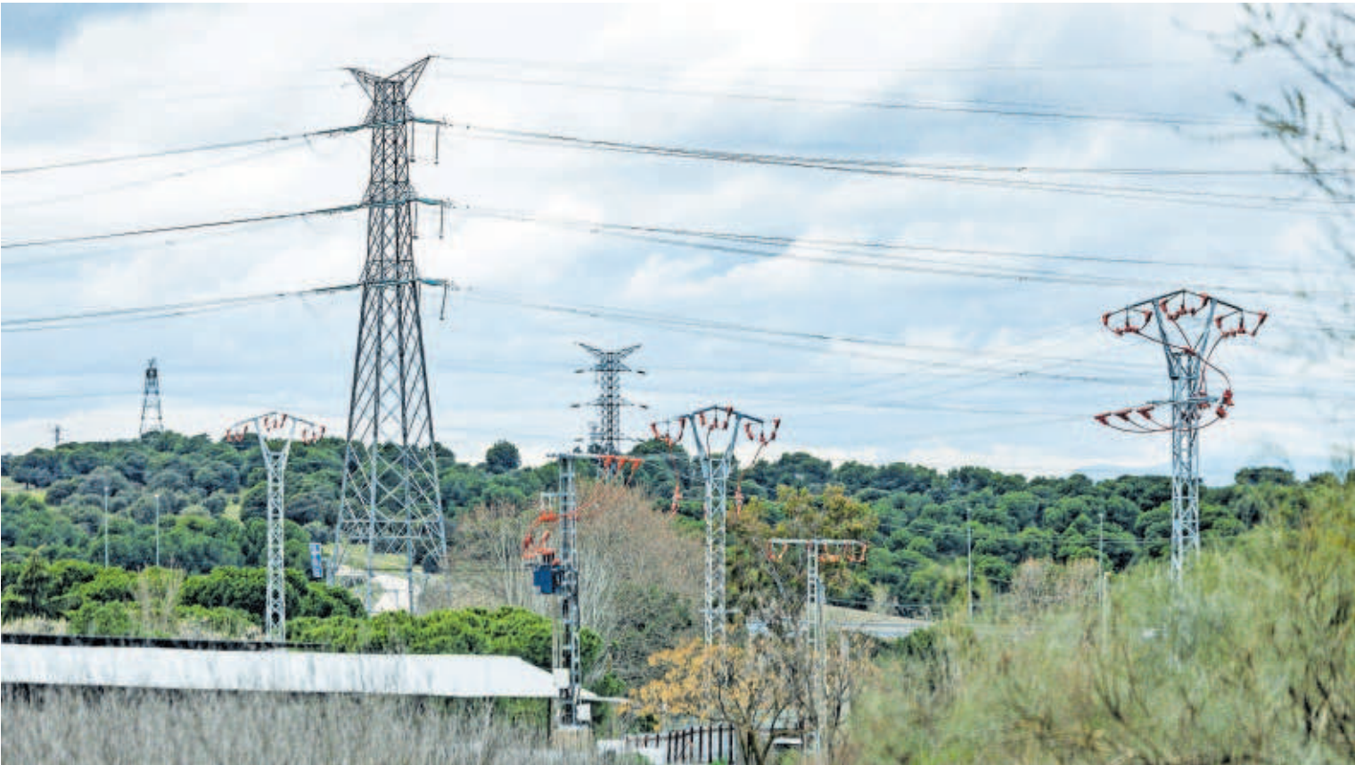
Una torre de tensión eléctrica, a las afueras de Madrid. RICARDO RUBIO (EP)
