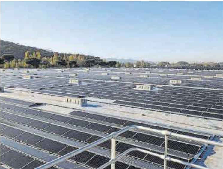
Imatge del parc fotovoltaic situat a l’ETAP Ter
