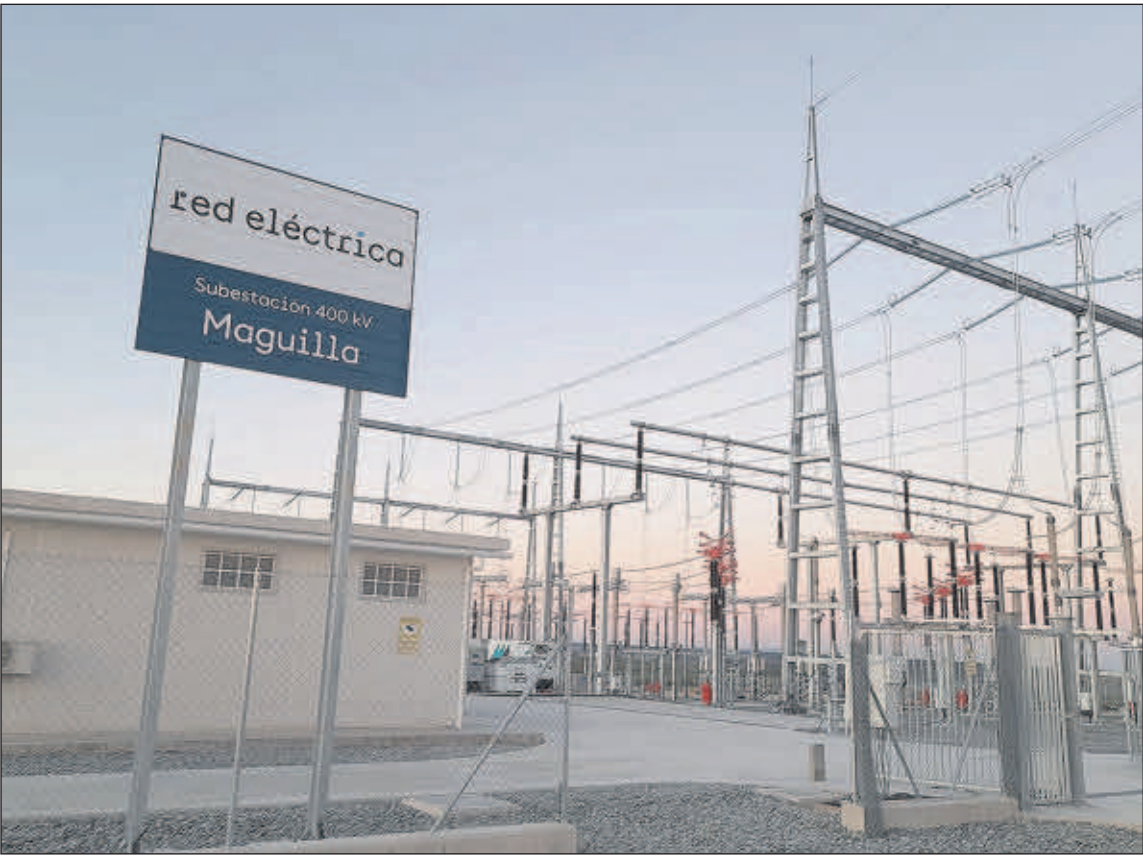
Subestación de Red Eléctrica de Maguilla, en Badajoz. EE
