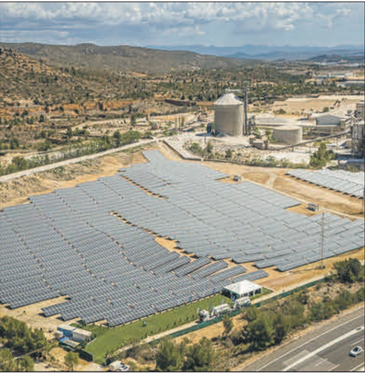
Instalación de ID Energy. EE
