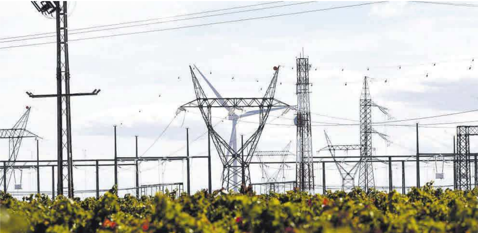
Varias torres de la red de transporte y de distribución de electricidad.
