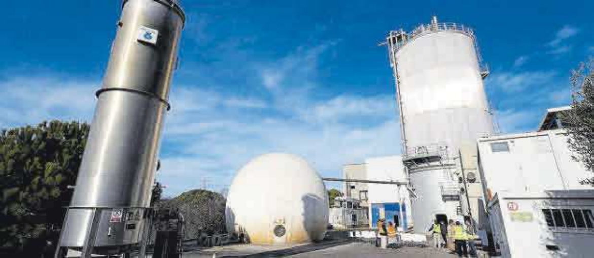
Planta de tratamiento de residuos orgánicos de Can Barba, ubicada entre Sabadell y Terrassa donde se produce biogás a partir de residuos. / FERRAN NADEU
