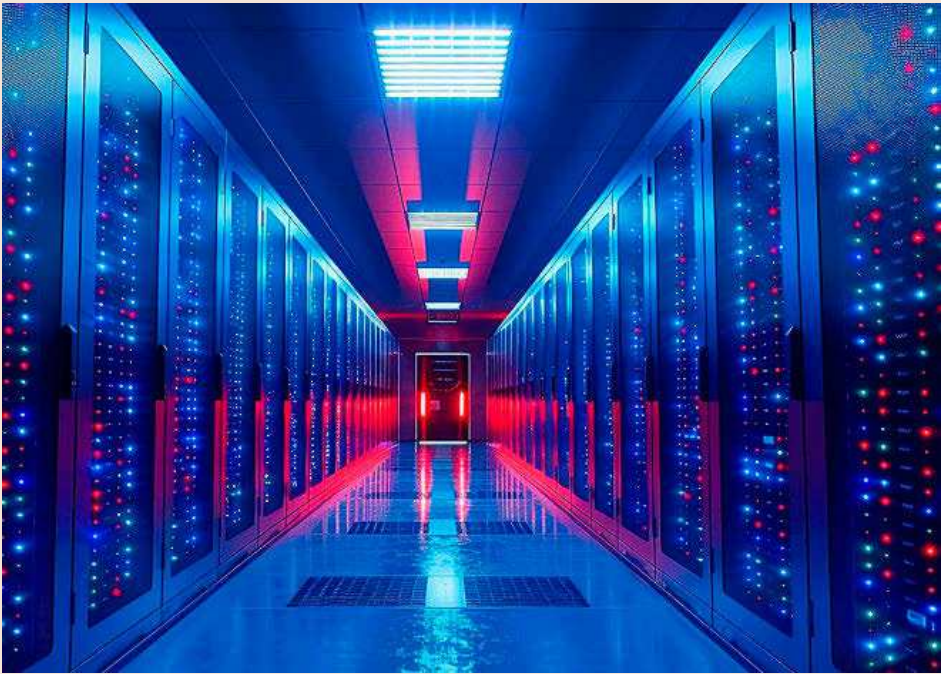
Imagen del interior de un centro de datos.
