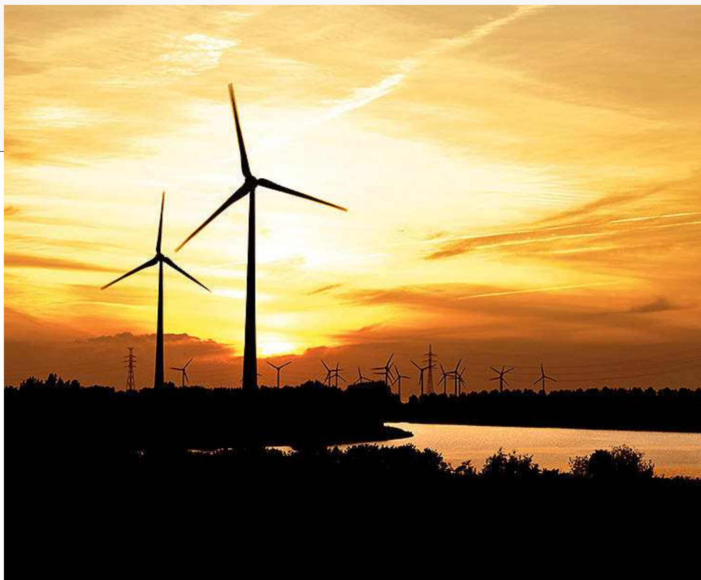
Planta eólica de Shneider Electric
