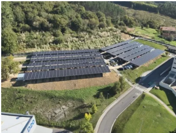
ITP Aero acelera su transición energética con casi 2 MW de autoconsumo desplegados por Edison Next
