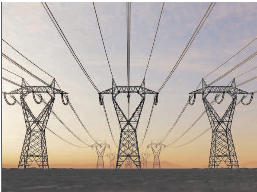
Varias líneas eléctricas. ISTOCK
