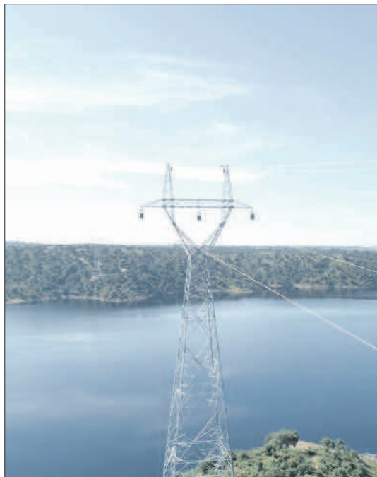
Línea de transmisión eléctrica Ceclavín, en España. EE
